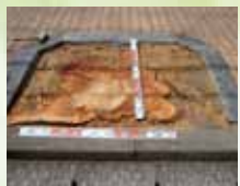
心材腐朽(白色腐朽)
